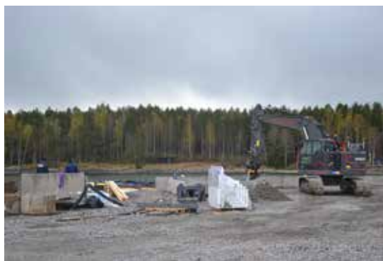
Idag en byggarbetsplats och här läggs grunden till det som ska bli produktionslokal, rökeri, butik och restaurang vid Saltharsfjärdens fiskeläge.
