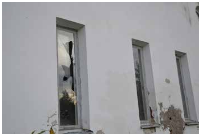
Två fönster har krossats vid Industrimuseet Kastellet
